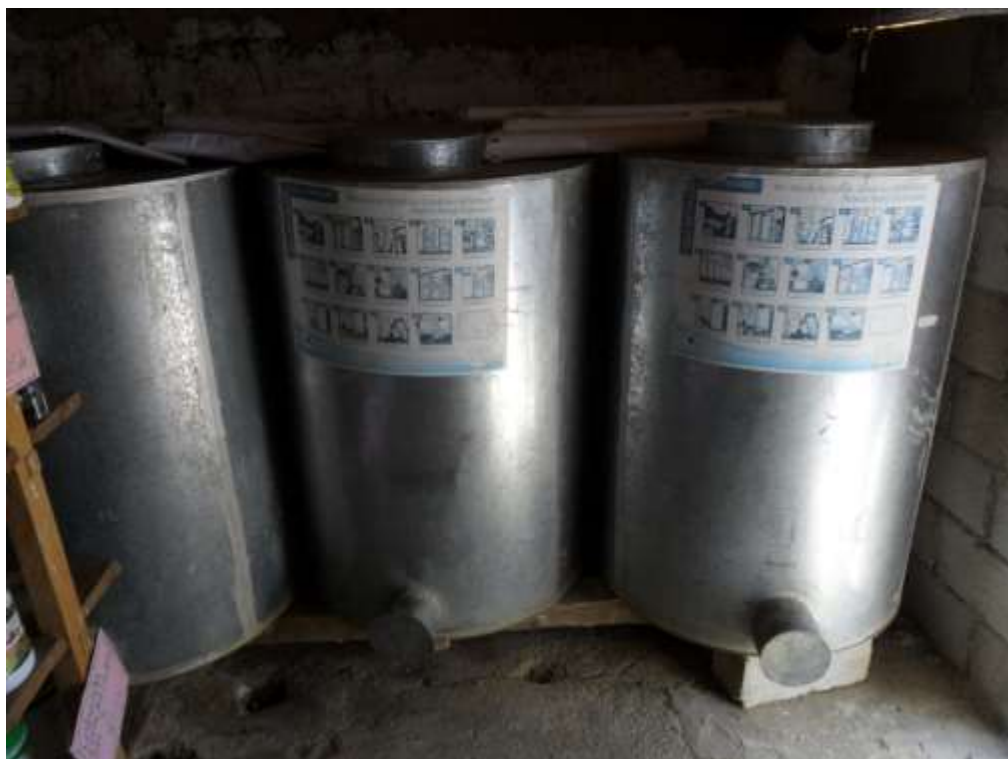
Fotografía 3. Silos para servicio de emergencia.
